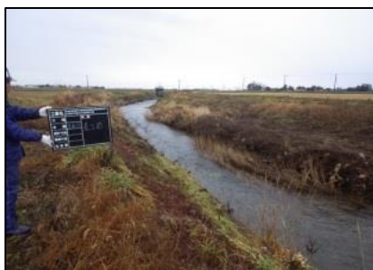
写真 5.1-12 千原橋上流 土砂堆積状況
