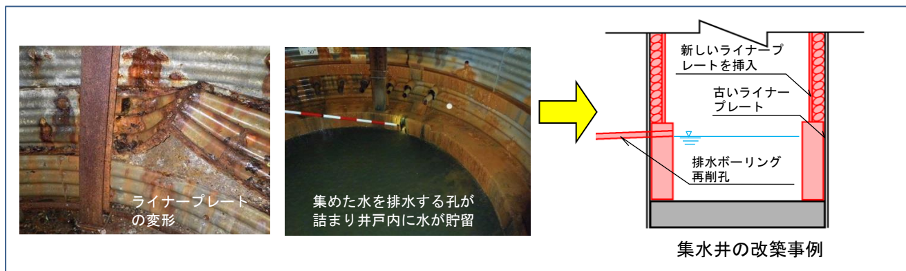
図 5.2-14 地すべり防止施設（集水井）の損傷状況及び改築事例
