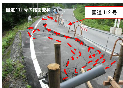
写真 5.2-22 志津地区の地すべり
