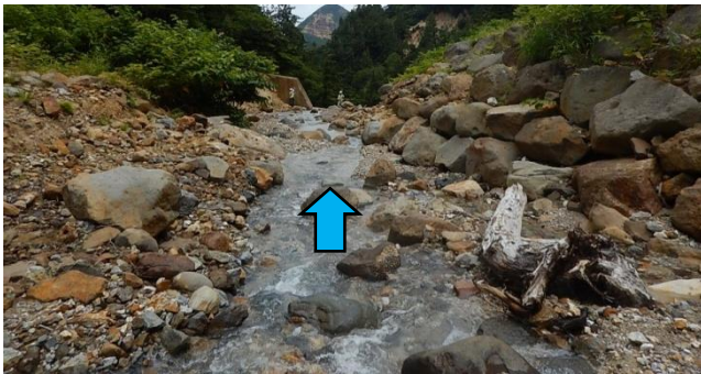
写真 5.2-17 異常堆砂した不透過型砂防えん堤
