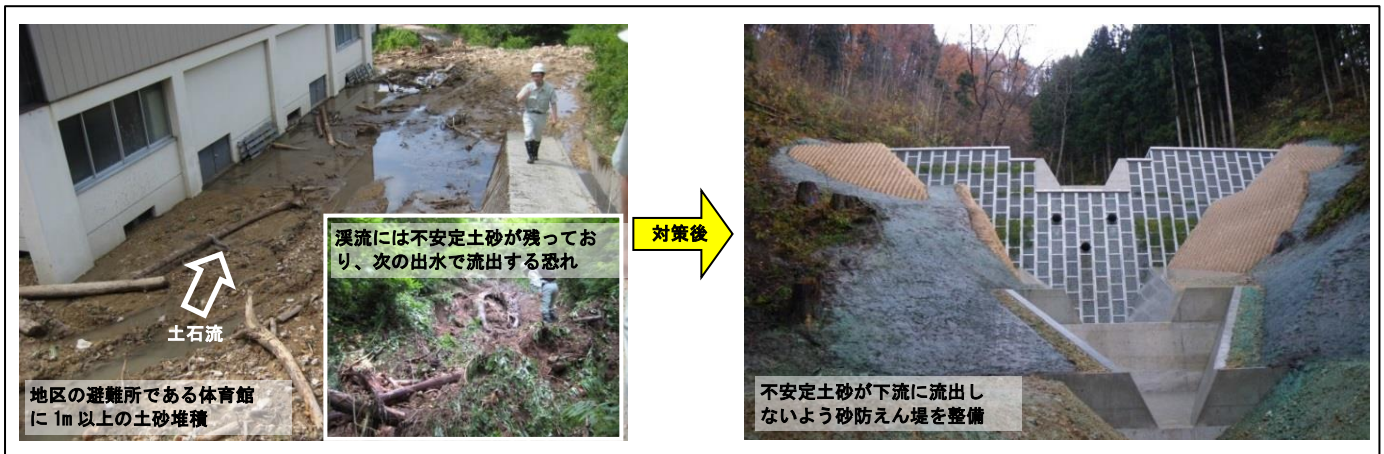
写真 5.2-9 災害発生箇所における対策事例（砂防事業） 中畑沢（朝日町）
