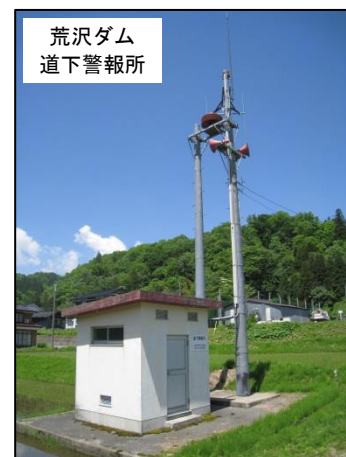
写真5.1-4 放流警報設備の設置状況
