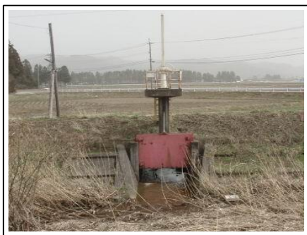
写真 5.1-16 樋門の設置例
