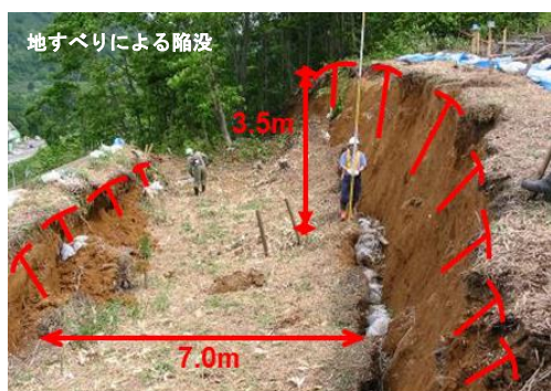
写真 5.2-21 田麦俣地区の地すべり
