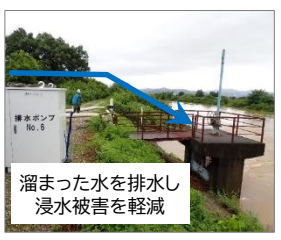
R4稼働状況(黒川:川西町黒川)
