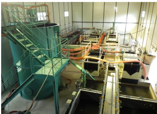
写真：濁水処理設備内部の様子 (奥側より手前側へ処理していきます)
