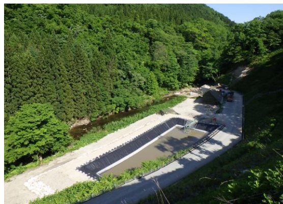
写真：貯留池 (濁水を一時溜めておきます)
