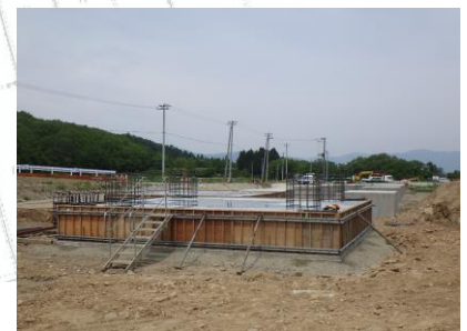
写真：コンクリート製造設備から骨材輸送設備の基礎を施工中
