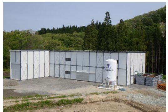
写真：濁水処理設備全景
