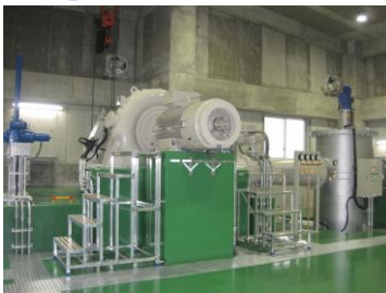
白水川ダム管理用発電所
