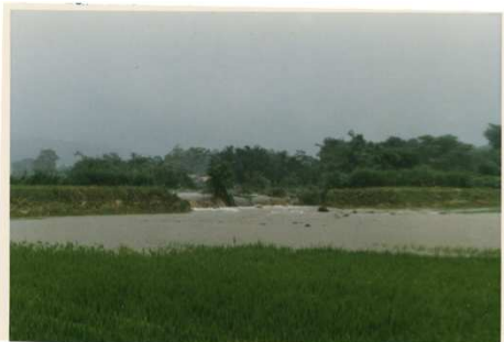
庄内高瀬川の 堤防決壊箇所
