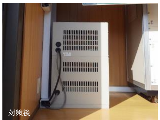
▲ 対策例（榑下水位・雨量観測所） 直流電源装置更新
