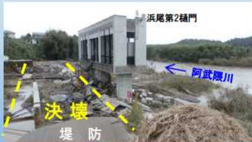
98.6k 左岸堤防決壊箇所(須賀川市)
