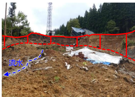
－ 斜面頭部（滑落崖）の状況 －
