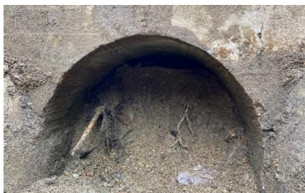
三光堰用水路 トンネル閉塞
