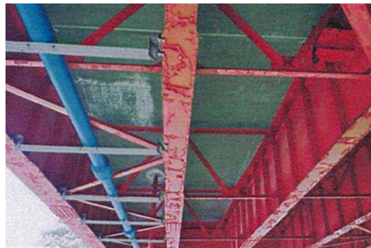
砕石によるマウンドアップ歩道箇所における床版下面の遊離石灰（歩道下に集中）
