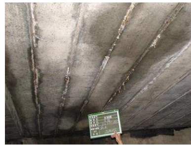
PC 床版橋の間詰め部からの遊離石灰
