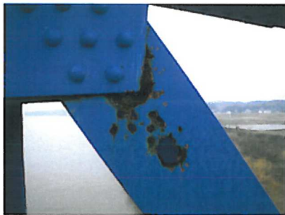
トラス斜材（溝形鋼）の内側に蓄積した飛来塩分による孔食
