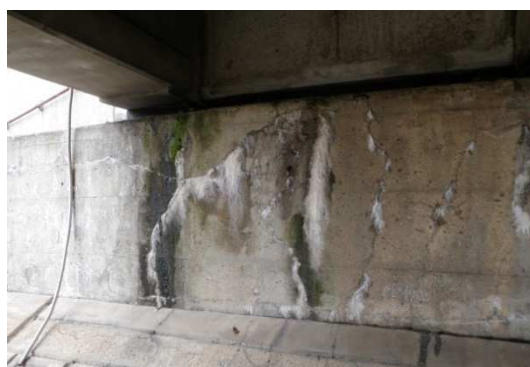
図-1.6 アルカリ骨材反応による損傷事例
