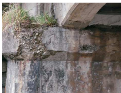
図-1.3 凍害による損傷事例
