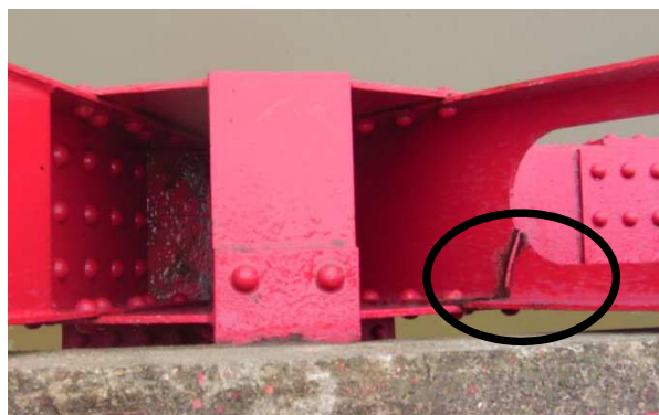
図-1.7 風による鋼部材の疲労損傷の事例（トラス斜材の破断）
