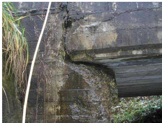
橋座部の凍害によるスレーキング
