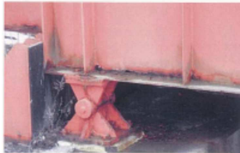
桁端部の腐食による下フランジとウェブの剥離（伸縮装置からの漏水）
