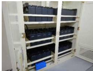
中央病院 無停電電源装置（現状）
