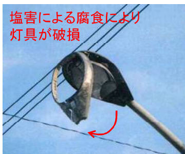
照明灯更新前
