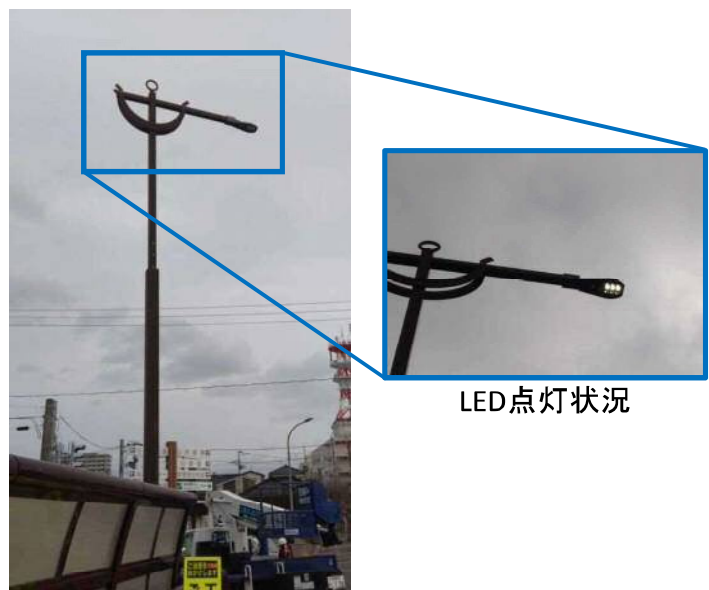
照明灯更新後
