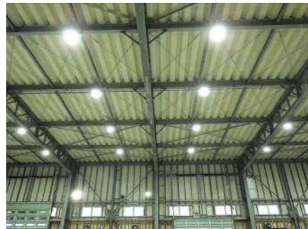
・LED照明への更新
