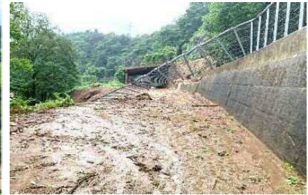
一般国道344号 道路路面崩壊（真室川町 高坂）
