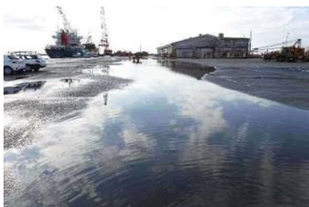
大浜ふ頭の舗装沈下状況
