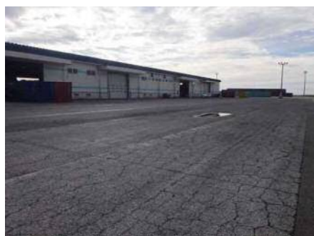
改良前（ひび割れ）
