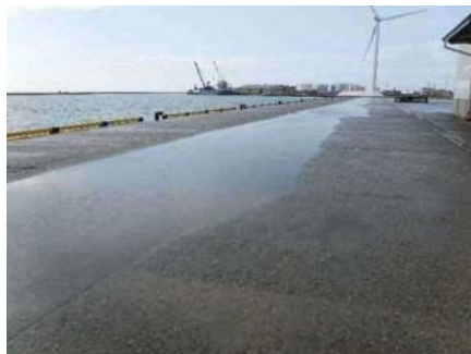
西ふ頭の舗装沈下状況
