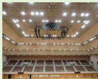
照明設備(R3完了)
