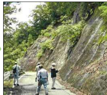
現地にて変状部を効率的に点検
