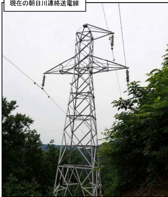
現在の朝日川連絡送電線
