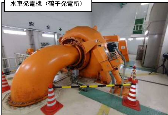
水車発電機（鶴子発電所）
