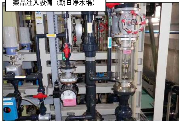
薬品注入設備（朝日浄水場）
