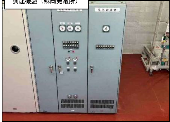
調速機盤（蘇岡発電所）
