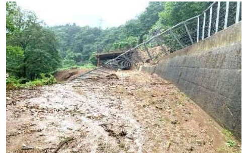
一般国道344号 道路法面崩壊（真室川町 高坂）
