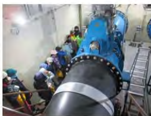
赤川地区小水力発電所
