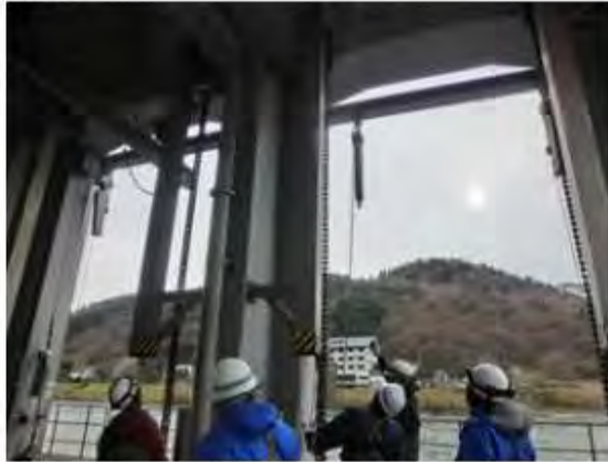
取入口 鋼材のザビ具合を確認
