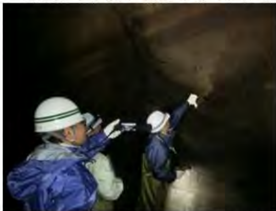
内壁浸食部分の深さを測定
