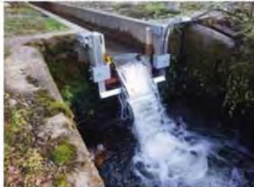
マイクロ出羽水車による発電の状況
