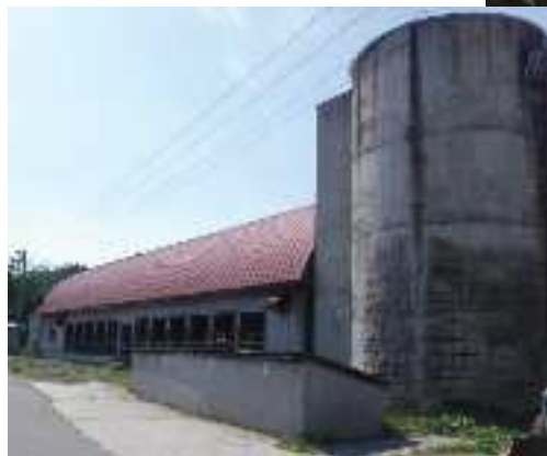
老朽化している置賜農業高校の畜産実習施設（牛舎）
