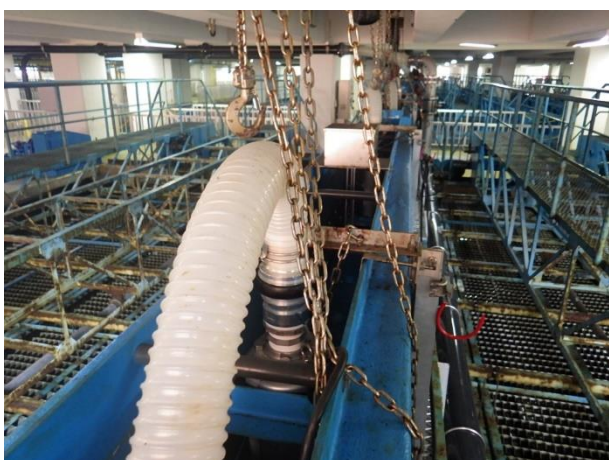
沈殿池中間取出し装置(村山)
