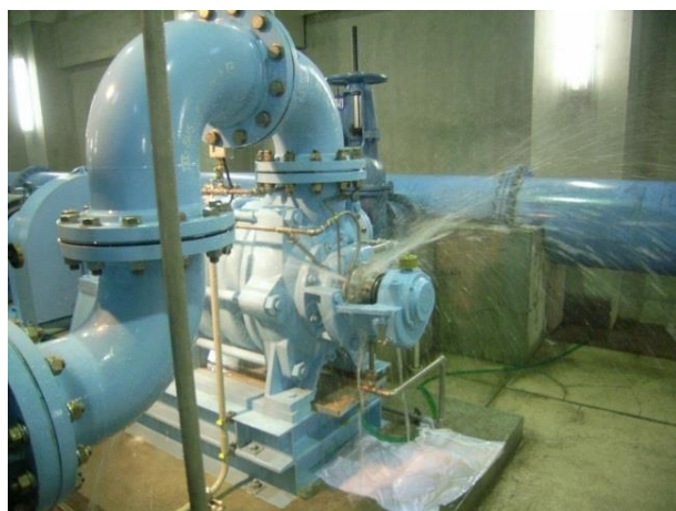
東日本大震災時の送水ポンプからの漏水(村山)
