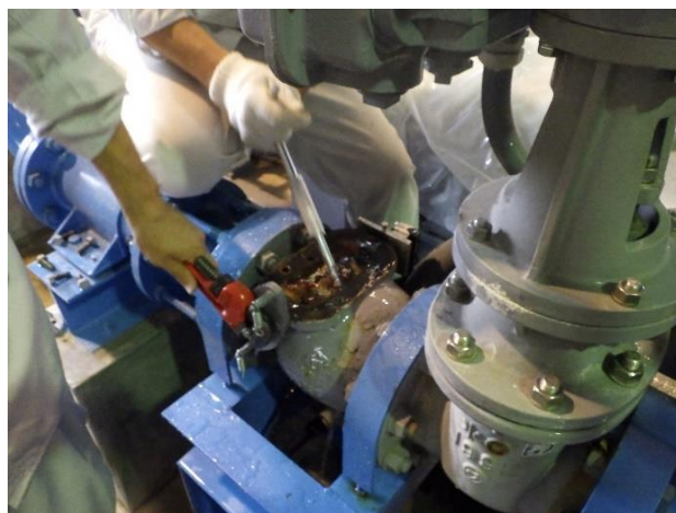
ポンプ点検(最上)
