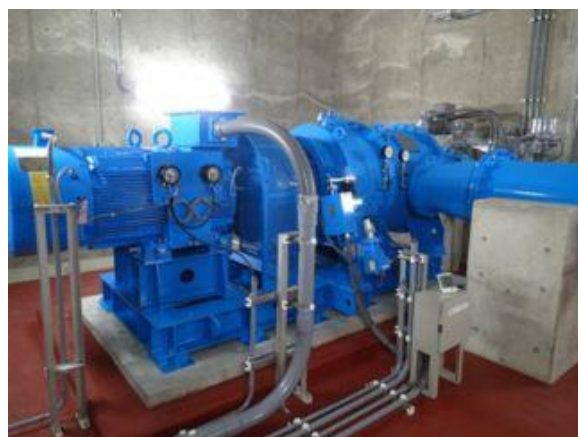
鶴岡量水所小水力発電設備
