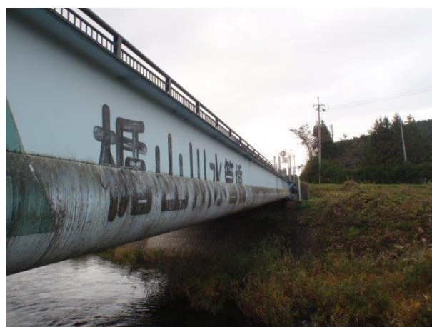
水管橋の老朽化状況(庄内北部)
