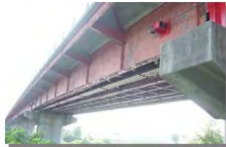
塗膜劣化による錆→放置すると腐食
