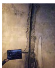
小規模な損傷
