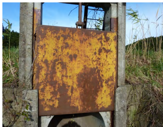
錆が扉体全体に発生し一部板厚が不足している
