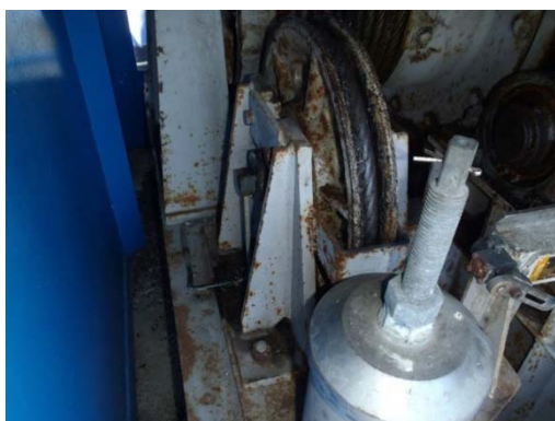
開閉装置(ロープ端末装置)の劣化により機能不全のおそれ (青龍寺川水門)
