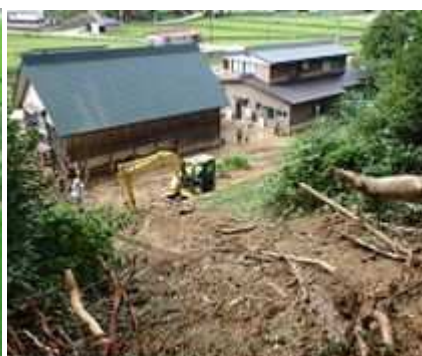
(民家裏の山腹崩壊)
