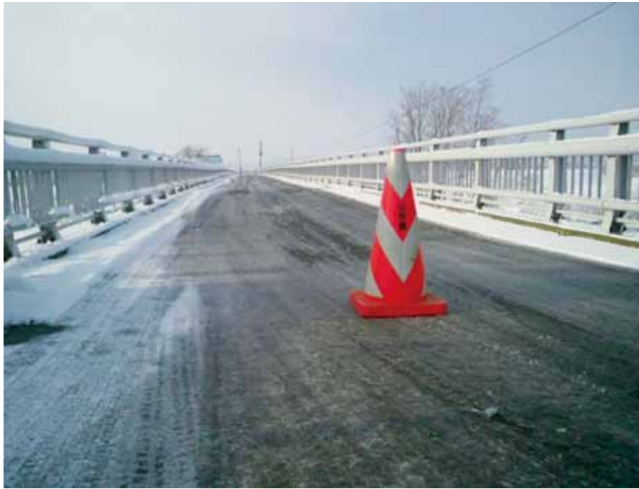
【一般県道天童河北線乱川橋の被災状況（橋面波打ち）】
