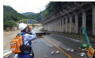
【TEC-FORCEによる被害状況調査】
