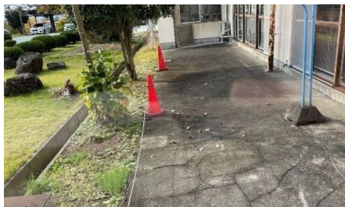
（本館 剥がれた軒天）
