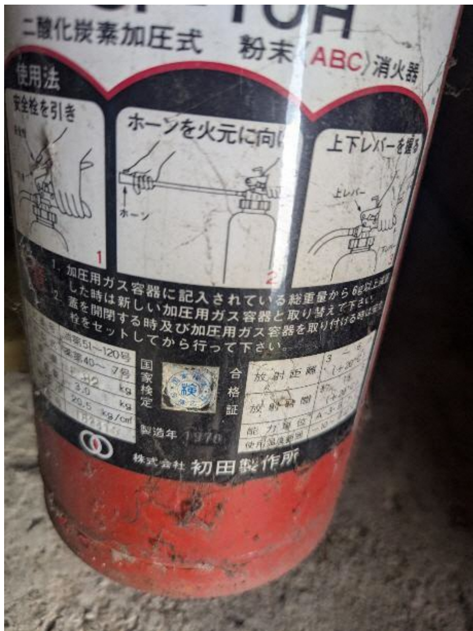
使用期限が切れた消火器（9月6日監査人撮影）
