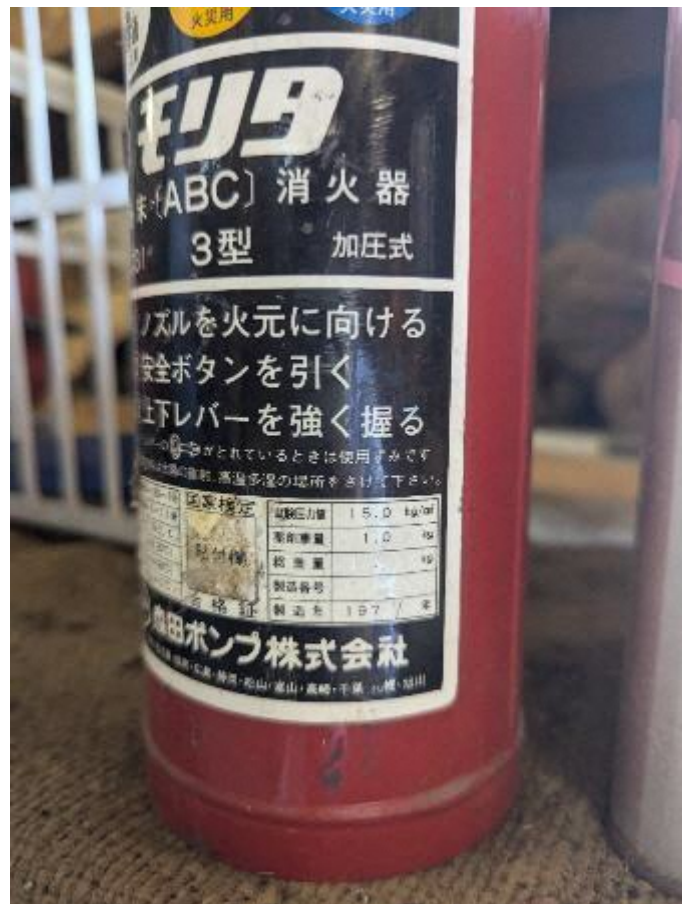
使用期限が切れた消火器（9月5日監査人撮影）
