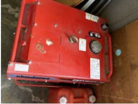
非常用発電機（令和6年9月4日監査人撮影）
