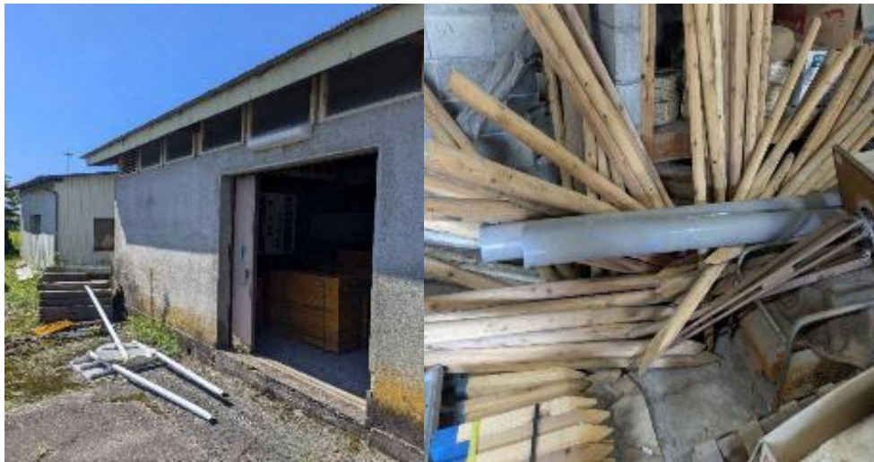
水防施設の外観と内部の写真（9月5日監査人撮影）
