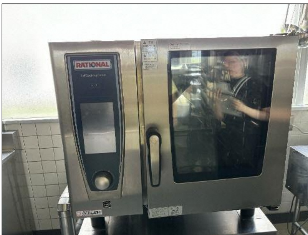
備品表示表未貼付備品（8月20日監査人撮影）
